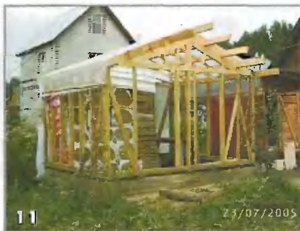
11 Поверх каркаса крыши настелил полиэтилен. Под такой временной крышей можно укрыть утеплитель от дождя
