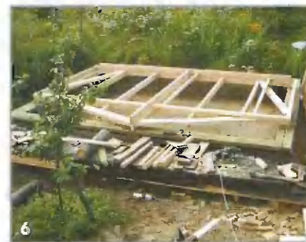
Каркас фронтонной стены собран таким образом, чтобы потом можно было уложить утеплитель расчетной толщины
