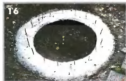
Перед заливкой железобетонного «ножа» в выкопанную на глубину 300...350 мм траншею следует уложить пленку, а затем установить арматуру с выпусками для связи со стенками колодезного кольца
